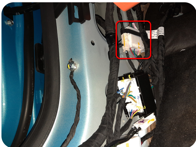
Подключение в белом 34-контактном разьеме за левой кик-панелью
